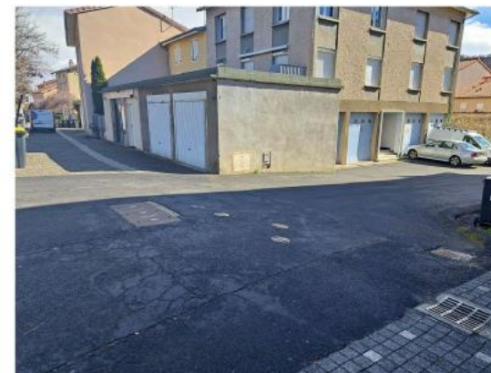
Mettre les grilles en conformité PMR
